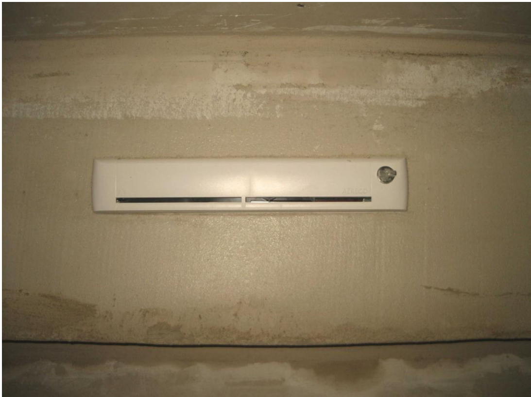
Bild 10: Ansicht Empfangsraum, Messung 8, Detail Lüfter
